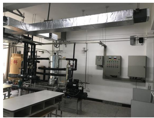
中央空调监控实训室
